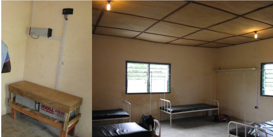
Solarbatterien, Laderegler und Wechselrichter (links) und Beleuchtung im Krankenzimmer (rechts)
