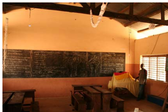
Installierte LED-Lampen im Klassenraum in Dogué
